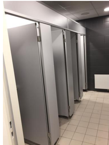
Sanitärrennwände in den WC-Anlagen
