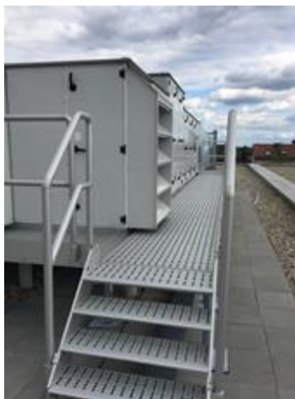
Wartungssteg einer Lüftungsanlage
