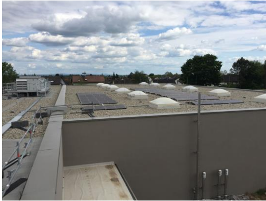
Photovoltaik auf dem Dach der Dreifeldhalle
