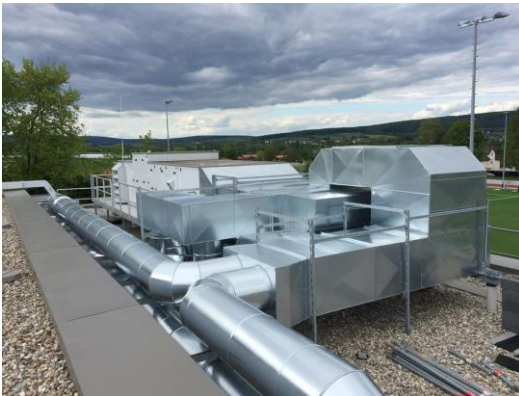
Lüftungsanlagen auf den Dächern der Ländcheshalle
